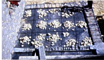
7- ثم يقع إغراق الشبكة الفولانية والحصى بملاط إسمنتي لتكون طبقة من الخرسانة المسلحة تلعب دور النظام الإنشائي للدمس.
