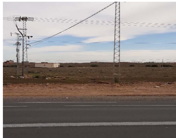
Photo 4 : Réseau STEG MT
