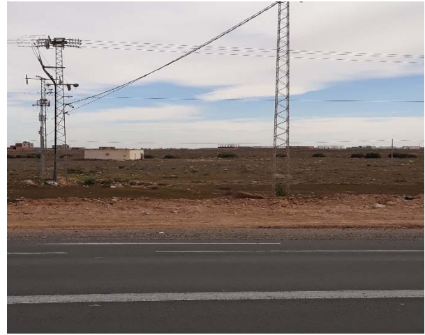
Photo 4 : Réseau STEG MT
