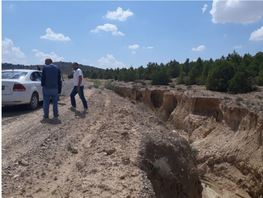
Photo 3 : Ecoulement longeant la route gauche
