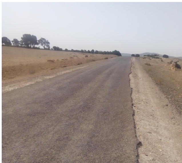
Photo 9 : Epaufrure et dénivellation des accotements
