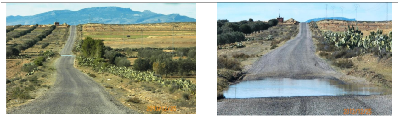
Stagnation des eaux de pluie au point bas sur la chaussée
