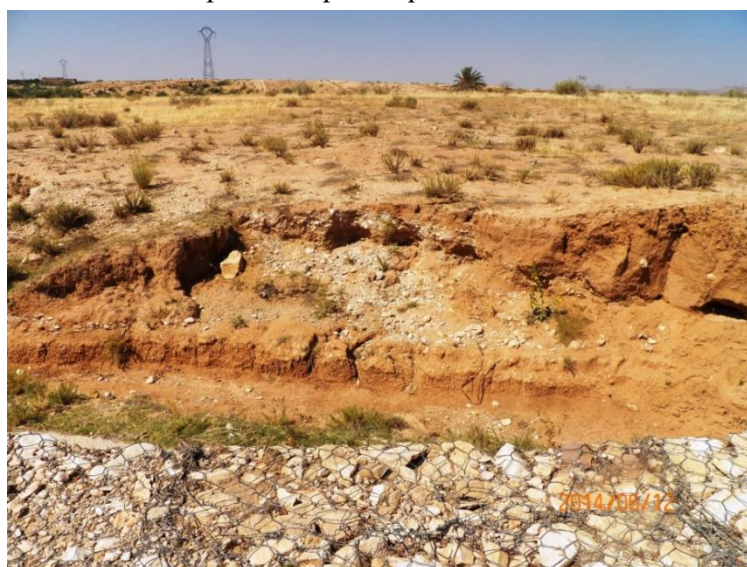
Figure 15 : Gîte de remblai au pk3.1
