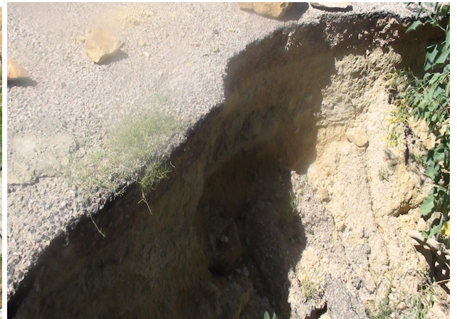
Photo n°9 : glissement de terrain
