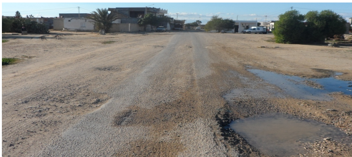
PK 1+400 : Stagnation d'eau
